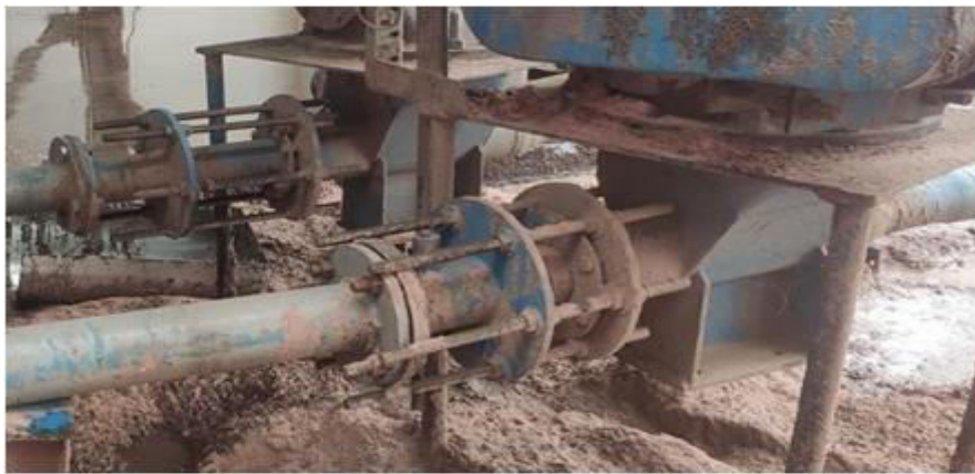
Pic1: Actual installed nozzle type Venturi.
